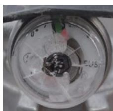
× 指示圧力計の損傷
