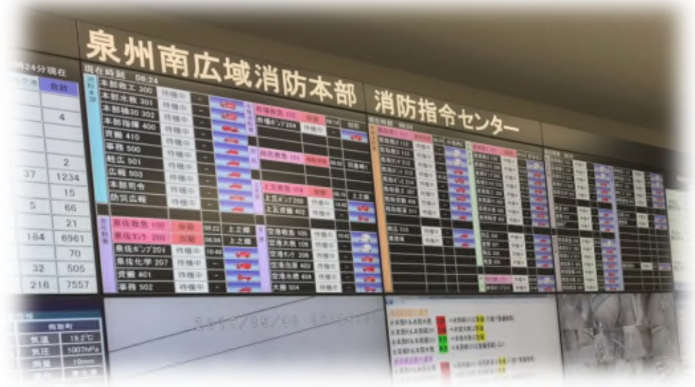
消防指令センター
