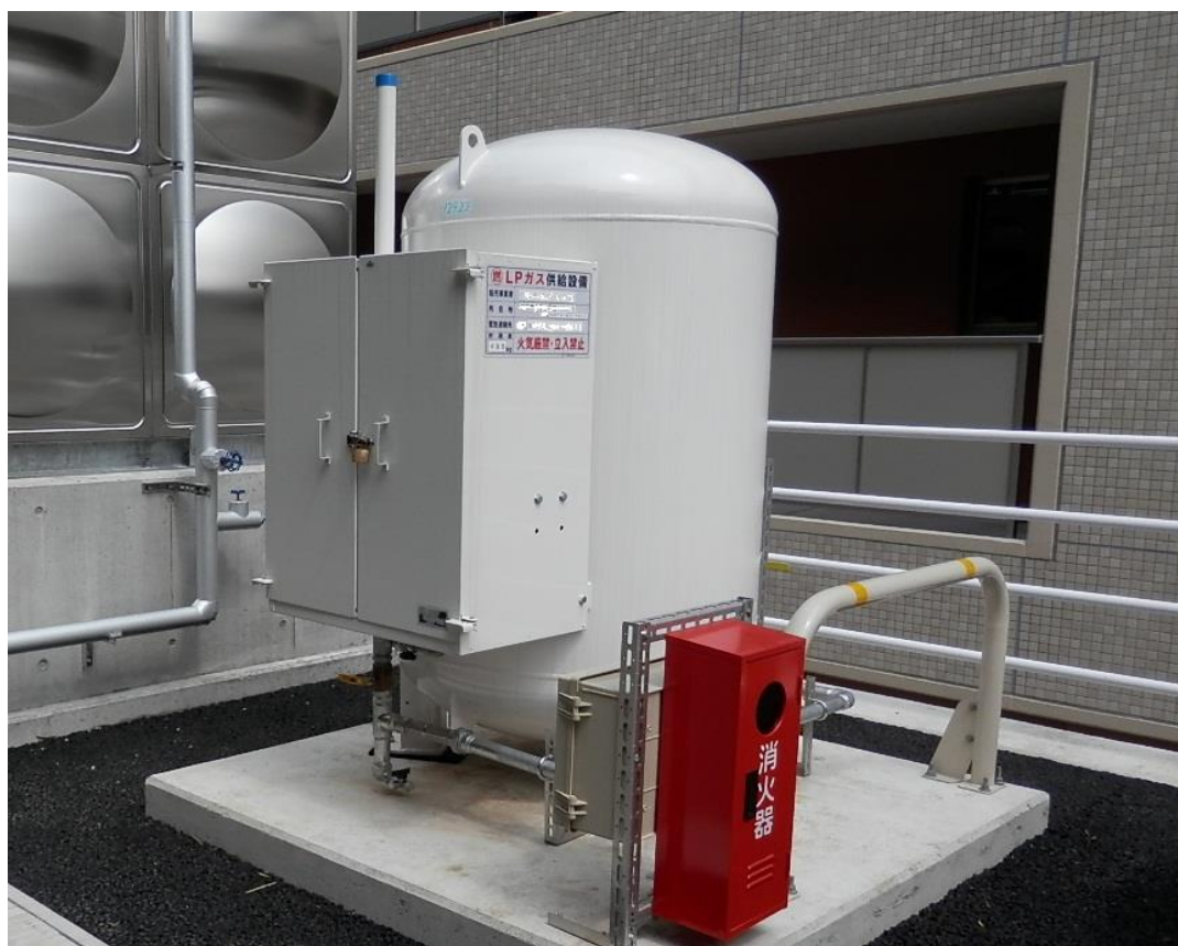
液化石油ガス バルク貯槽
