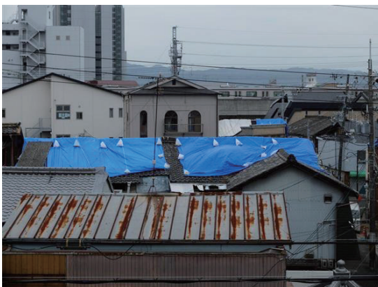
応急的に補修された住宅屋根の状況
